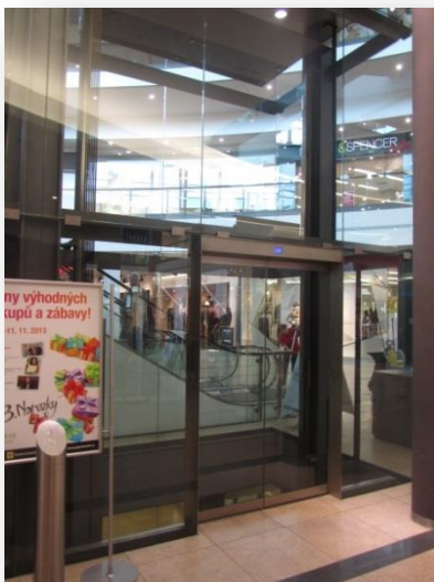
Obrázek 18: Výtahy a eskalátory slouží vertikální přepravě osob v dopravních terminálech, obchodních a společenských centrech, velmi často jsou součástí vnějších pěších tras
